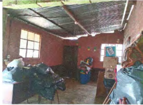
FOTOGRAFIA 2. SE PROPONE CAMBIAR TECHO POR LAMINA TROQUELADA Y COLOCACION DE ESTRUCTURA METALICA
