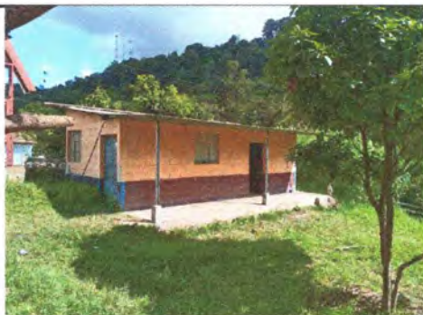
FOTOGRAFIA 3. SE PROPONE COLOCACION DE CERNIDO BLANCO EN MODULO DE LA COCINA
