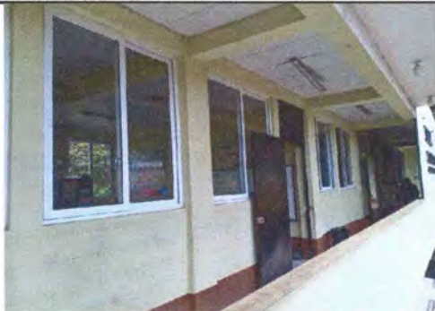
FOTOGRAFIA 1. SE PROPONE COLOCAR BALCONES EN TODAS LAS VENTANAS DEL EDIFICIO
